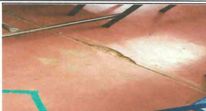
Foto 2: CAMBIO DE PISO ENTORTADO A CERAMICO SE ENCUENTRA YA DAÑADOS Y RAJADOS AULA 2
