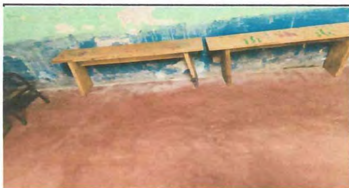
Foto 4: CAMBIO DE PISO ENTORTADO A CERAMICO SE ENCUENTRA YA DAÑADOS Y RAJADOS AULA 4
