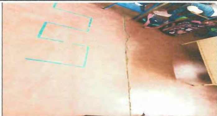
Foto 1: CAMBIO DE PISO ENTORTADO A CERAMICO SE ENCUENTRA YA DAÑADOS Y RAJADOS AULA 1
