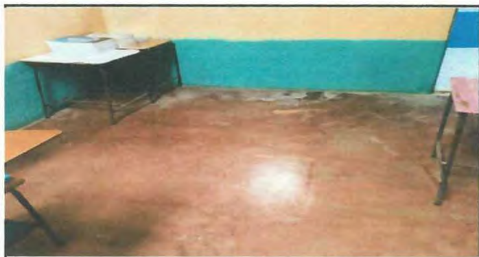
Foto 3: CAMBIO DE PISO ENTORTADO A CERAMICO SE ENCUENTRA YA DAÑADOS Y RAJADOS AULA 3
